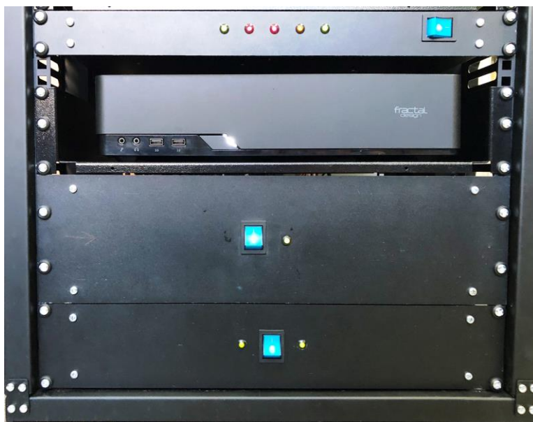
Пример реализации автоматизированного источника питания в составе оборудования.
